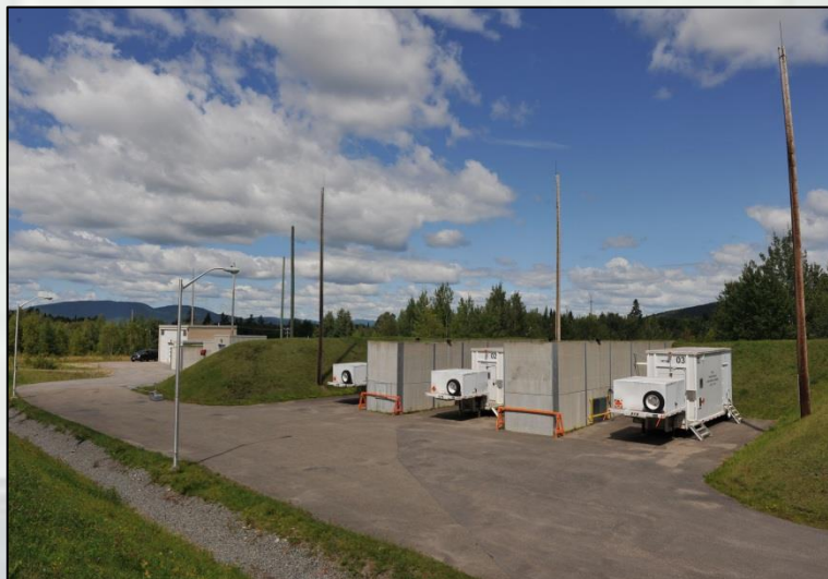
Chambres de conditionnement transportables (CCT, -55 °C à 75 °C).
